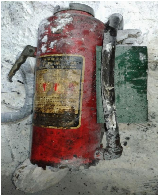
圖 1：滅火器底部嚴重鏽蝕
