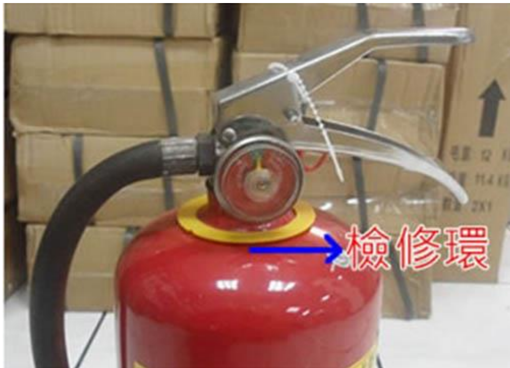
圖 4：滅火器加裝檢修環，兩色輪替提醒
